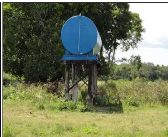
Figura 29 - Tanque de combustíveis localizado no Retiro Velho. Fonte: ARATER, 2018.
