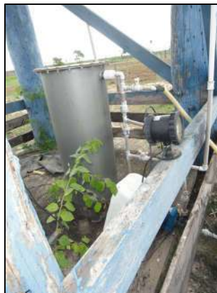
Figura 46 - Sistema de tratamento de água utilizado atualmente na fazenda. Fonte: ARATER, 2018.
