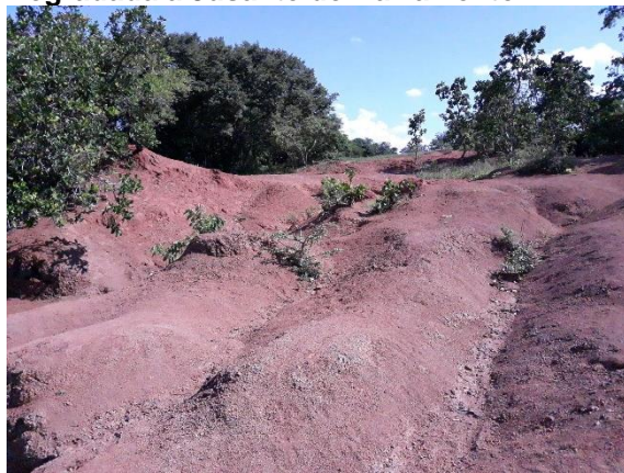
Figura 12.3: Situação atual da Área Degradada a Jusante do Barramento.
