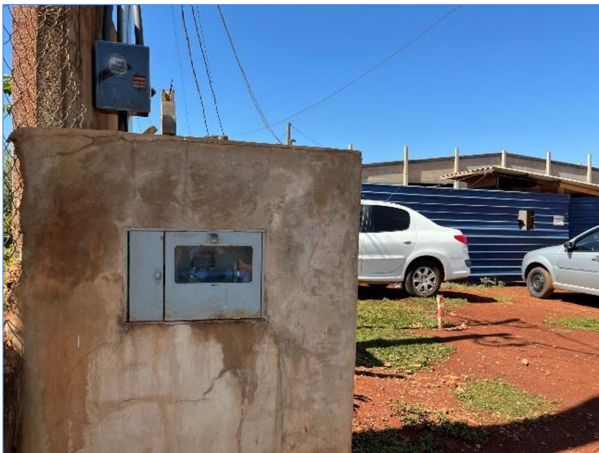
Figura 8 - Ligação com a rede de abastecimento de água da SANESUL. Fonte: MR2, 2023.
