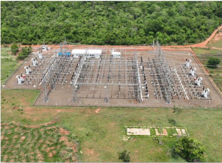
Bay 230 kV SE Inocência
