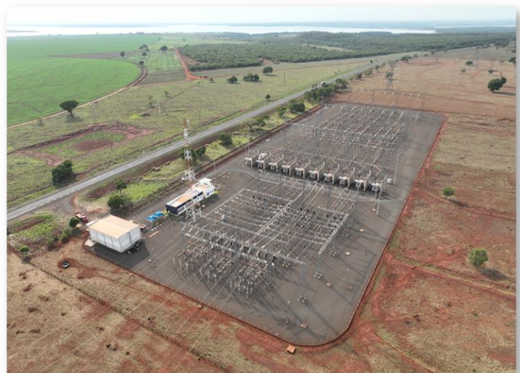
Bay 230 kV SE Ilha Solteira 2
